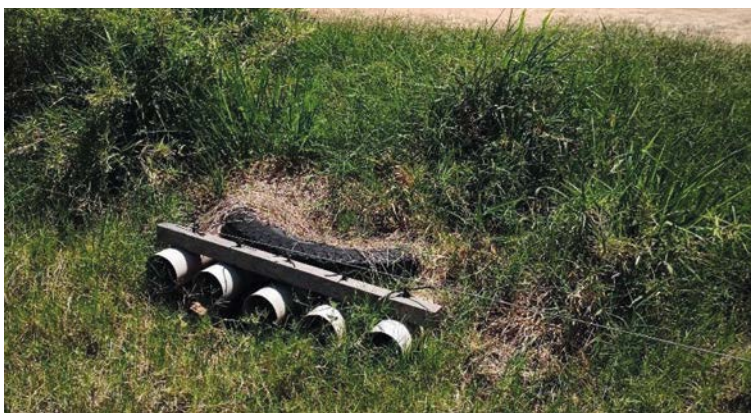
Fotografía 23. Alcantarillas de toma de agua en tajamares de sedimentación, diseñados para reducir introducción de sedimentos.
