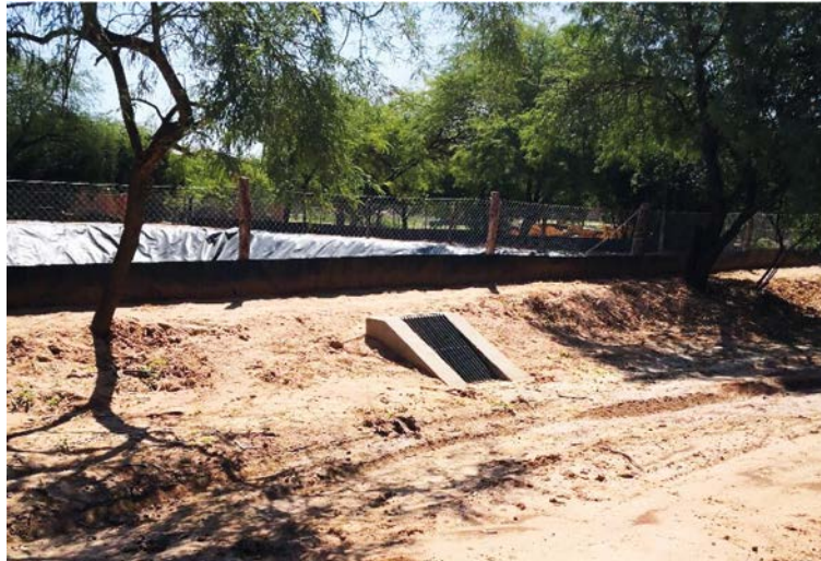
Fotografía 17. Reservorio impermeabilizado de almacenamiento de agua en área de servicios, Neuland.
